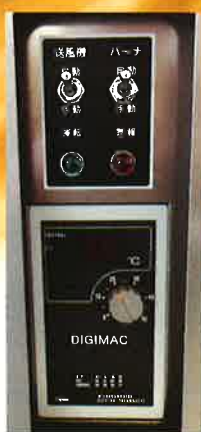
制御盤 (デジタル温度調節器)
